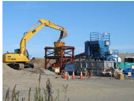
複合流動体製造プラント
