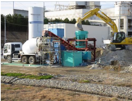
写真-8 本施工製造プラント全景
