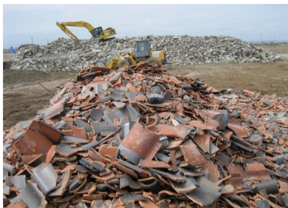
写真 1. 東日本大震災の廃棄瓦
