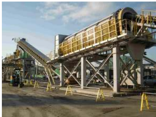
写真 3-1 土質改質施設(トロンメル混合機)
