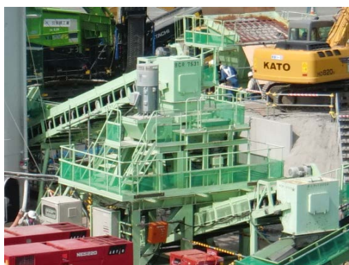
写真 4-1 土質改質施設（ツイスター混合機）
